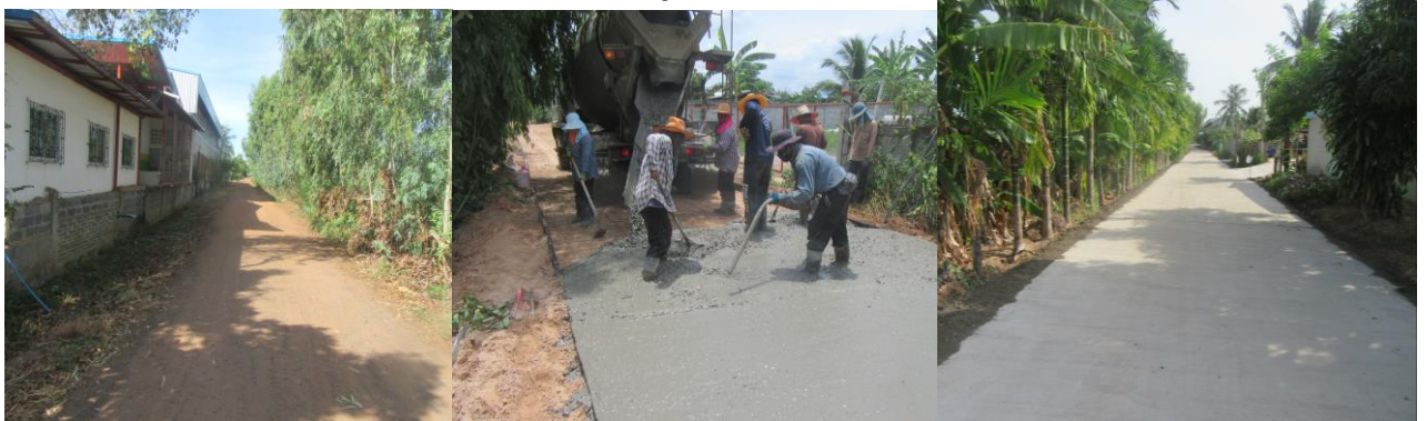
โครงการก่อสร้างถนนคอนกรีตเสริมเหล็ก หมู่ที่ 9 เส้นข้างโกดังนายสมยศ ทองหล่อ ไปที่พักสำนักสงฆ์
